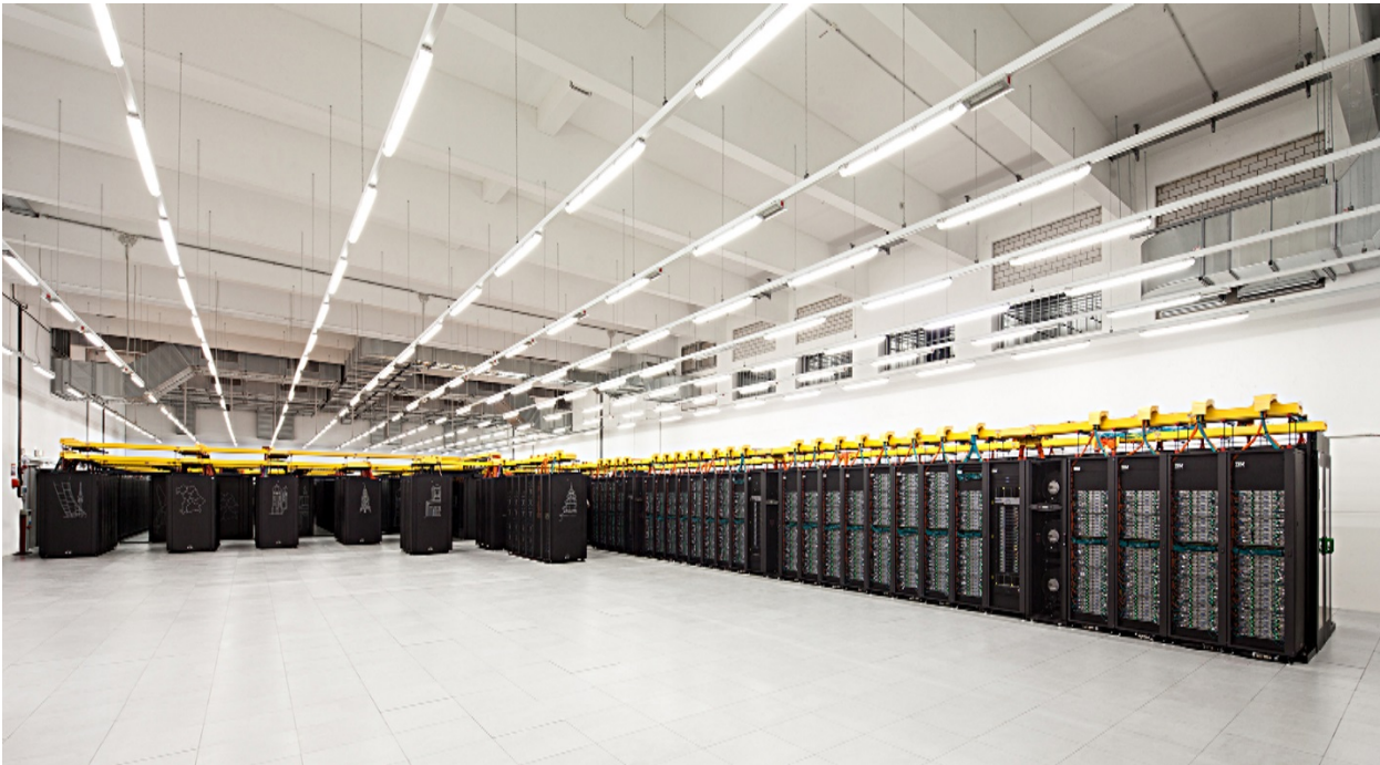
Abbildung 25: SuperMUC Phase 1 (hinten) und SuperMUC Phase 2 (rechts vorn) im Rechneraum. Trotz der mehr als doppelten Spitzenrechenleistung braucht Phase 2 nur etwa ein Viertel des Stellplatzes von Phase 1.
