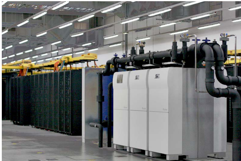
Abbildung 29: CooLMUC-2-Rechnerracks (schwarze Racks) und 6 von der Abwärme der Rechnerracks betriebene Adsorptionskältemaschinen (hellgraue Geräte rechts im Bild)
